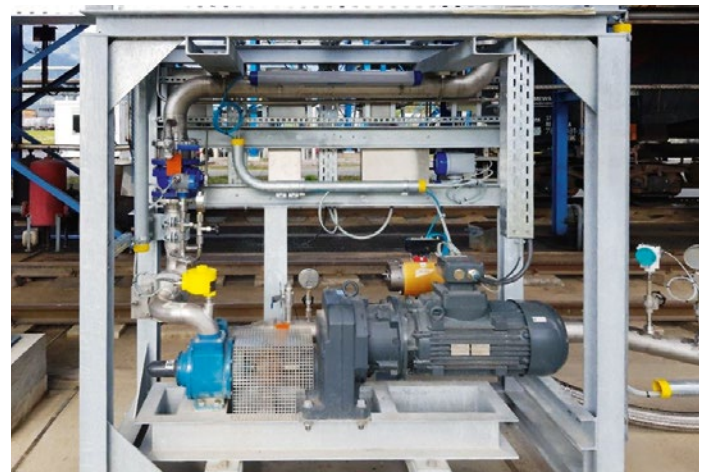
Einlagerungs Pumpe – Skid von INRAG
